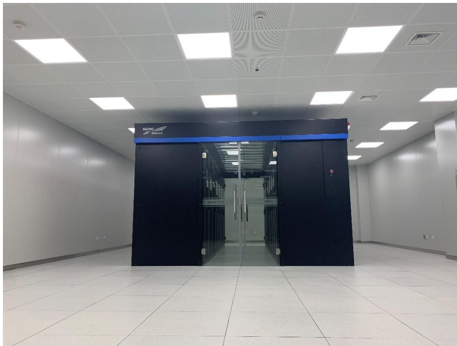
图5 高效、节能、可扩展的数据中心模块式冷通道机房
