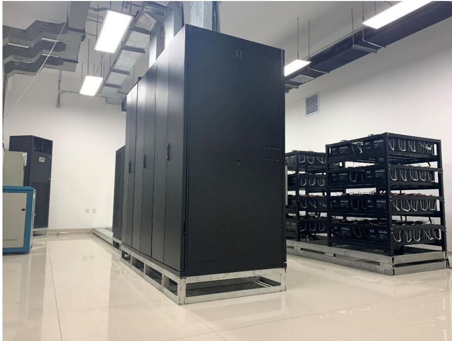
图4 A级标准建设的数据中心机房配电室
